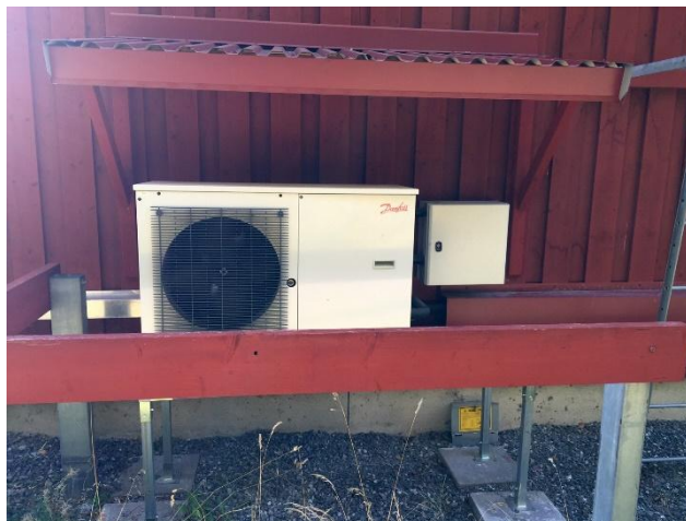
Bild 1 Frånluftsvärmepump vid bryggeriets norra fasad
