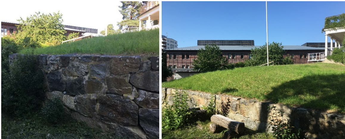
Befintlig stödmur och marken som lutar ut från huset.
